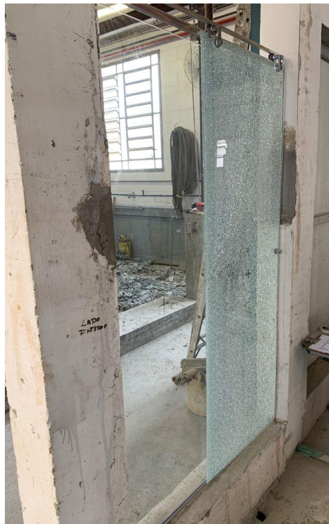
Foto n.º 06 – Visualização do ensaio de manutenção da estrutura do vidro temperado com película de segurança.
